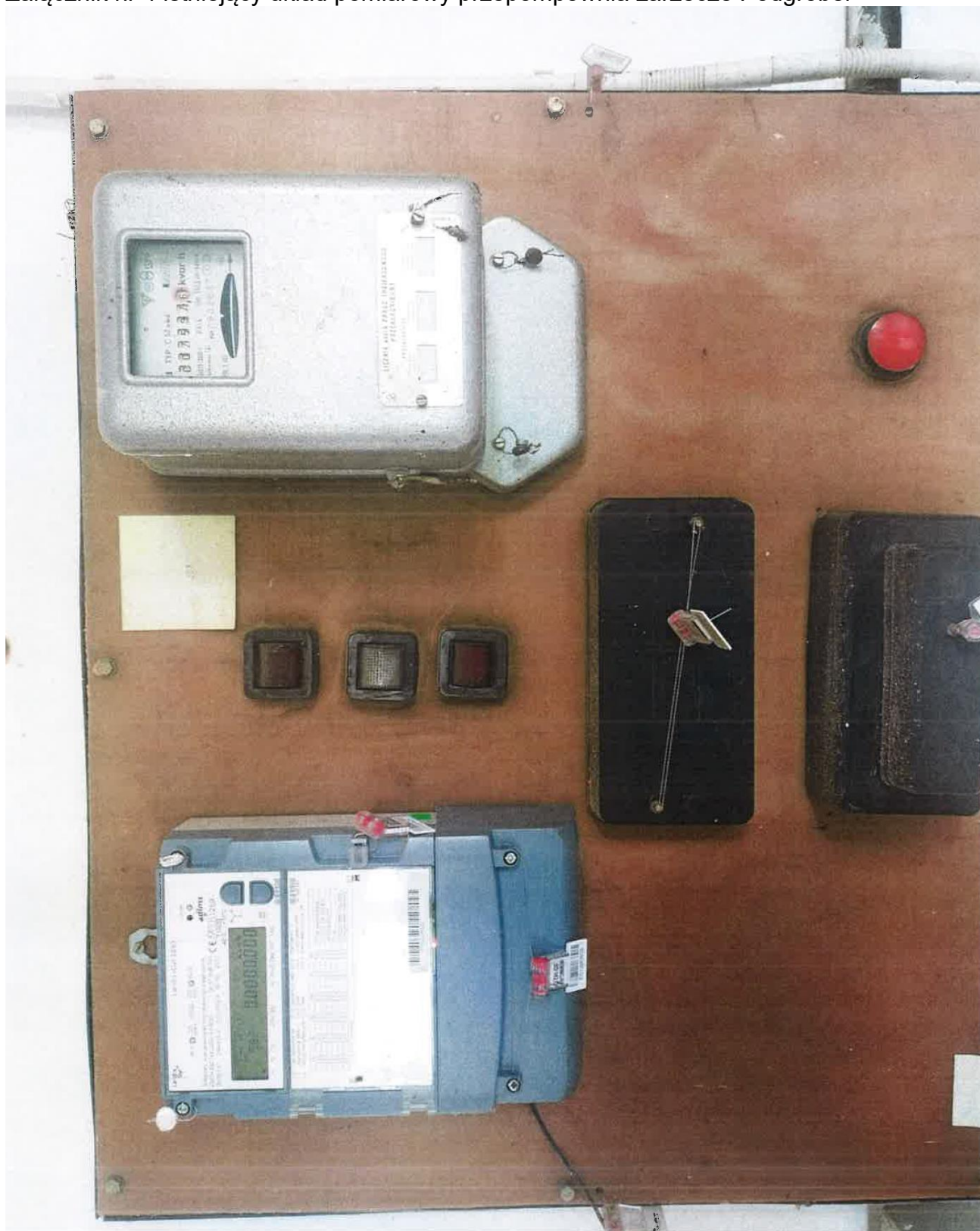
Załącznik nr 4 istniejący układ pomiarowy przepompownia zarzeczce Podgrobek
